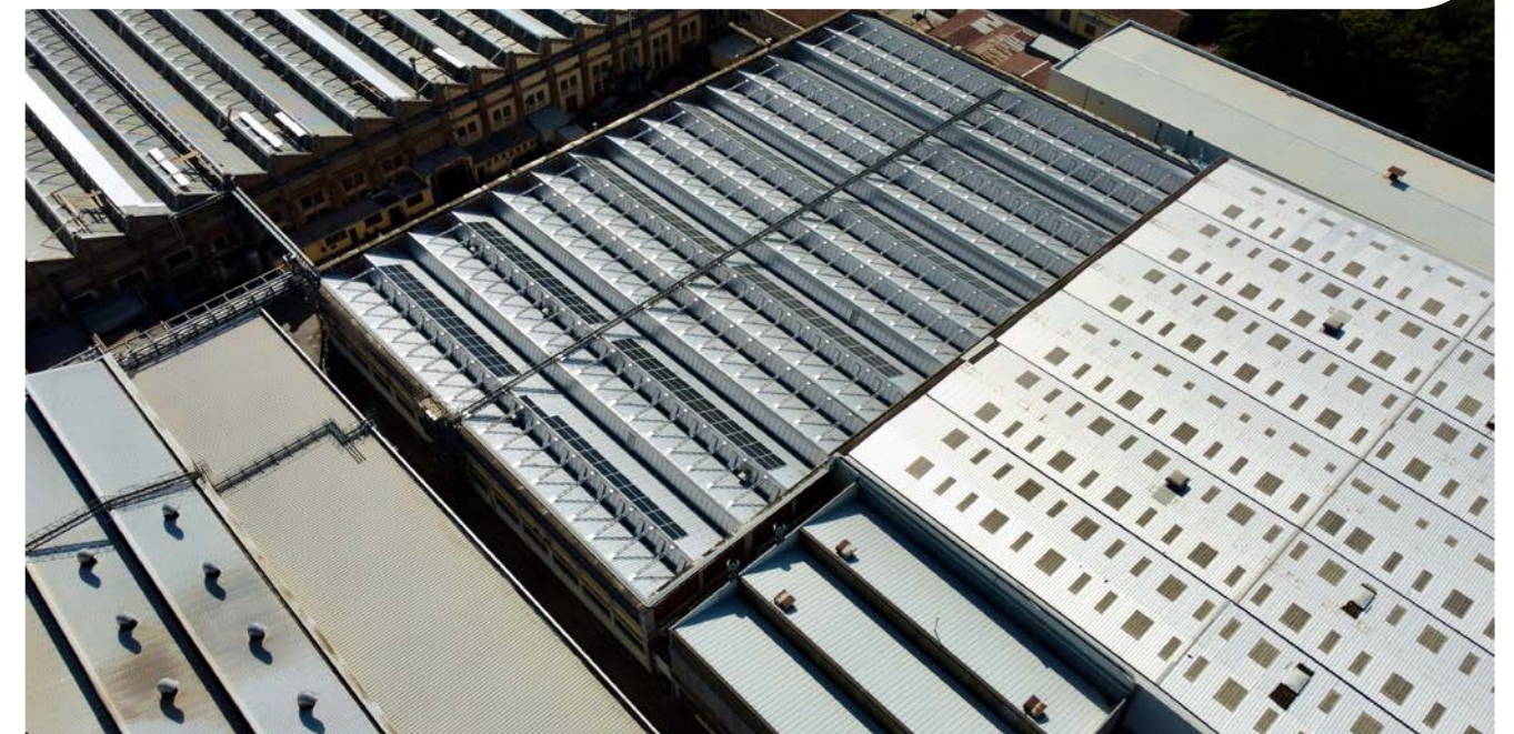
Impianto fotovoltaico, Foligno
